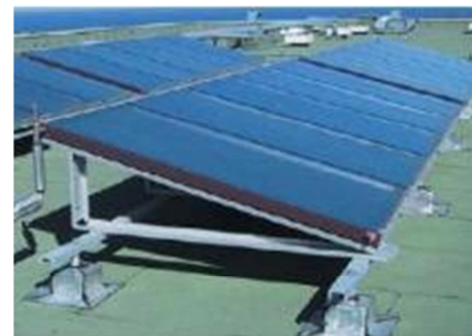
Capteurs solaires thermiques installés en toiture terrasse avec plots de fixation
