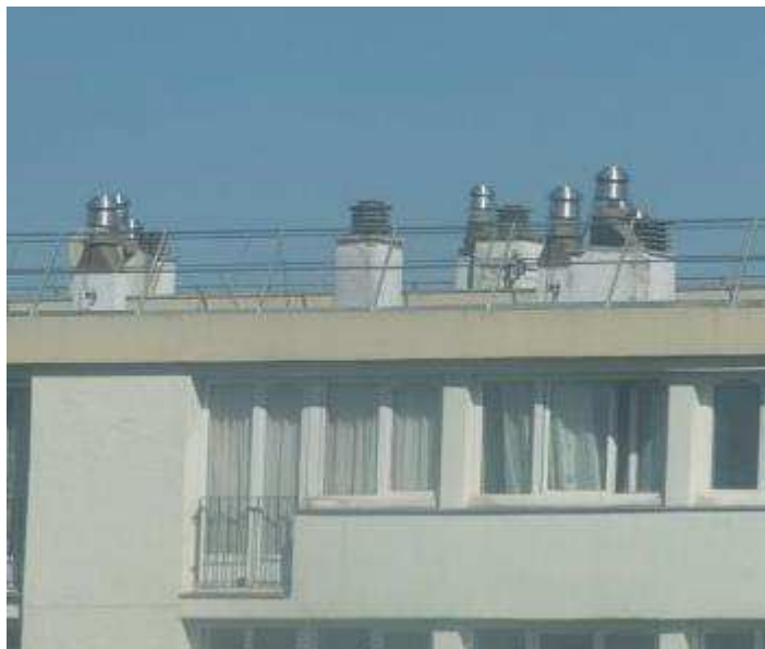
Tourelles d'extraction , cliché pris dans les Yvelines
