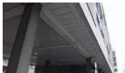
Hourdis difficiles à isoler, pas de retombée de poutre de rive
