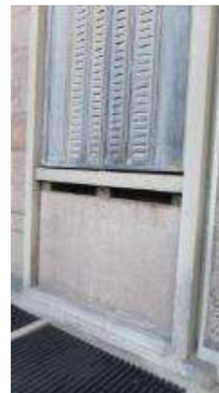
Ventilation de cave en allège du rdc
