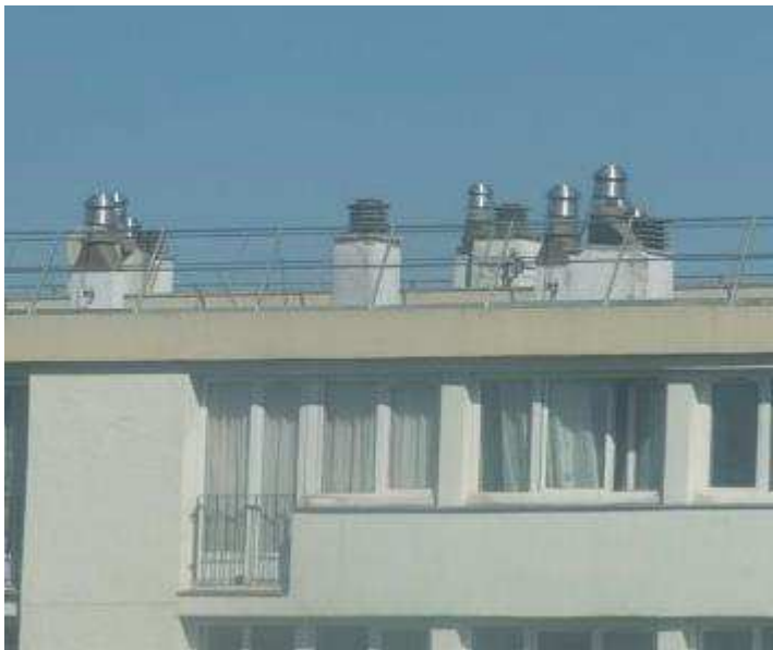
Tourelles d'extraction , cliché pris dans les Yvelines
