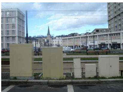
Porte Océane : Coffrets émergents
