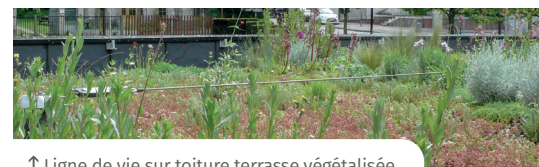
↑ Ligne de vie sur toiture terrasse végétalisée
