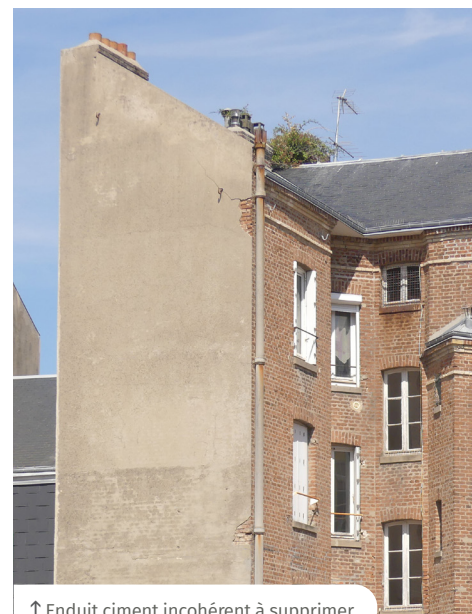
↑ Enduit ciment incohérent à supprimer
